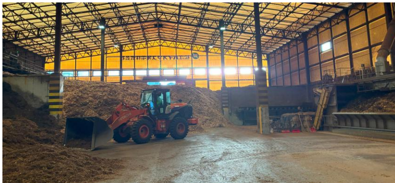
地域材チップ種別に保管し、ブレンドして専焼発電 (晴れた日は屋外に出して天日乾燥実施)
