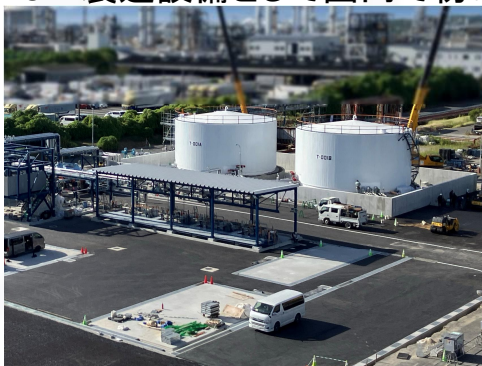
廃食用油受け入れ設備
