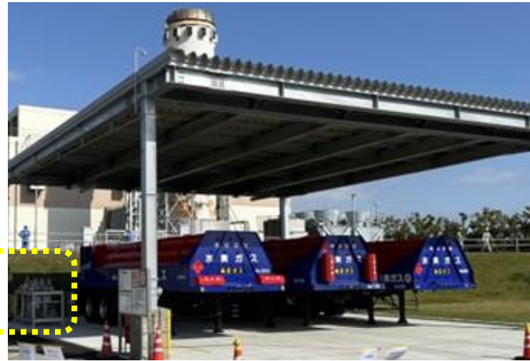
新設：水素ガス供給設備外観
