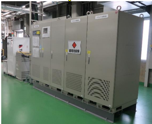
<工場既設側設備（蓄電池付きDC-AC）>
