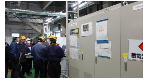
＜蓄電装置側操作説明風景＞
