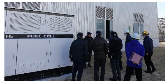
＜水素発電機操作説明風景＞
