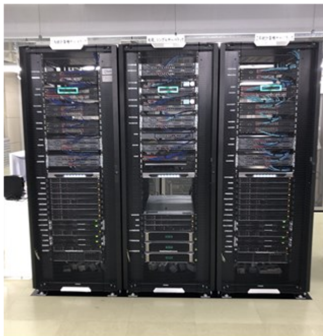
図 4-43 サーバ拠点 B に設置した系統制約・需給制約マネジメントシステムサーバ外観図
