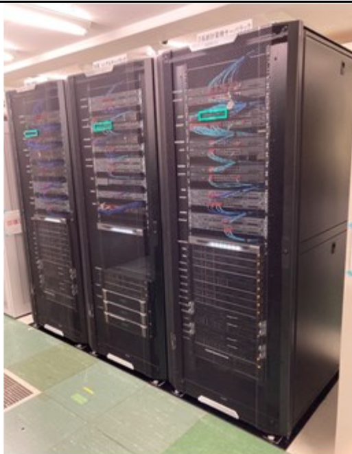
図 4-42 サーバ拠点 A に設置した系統制約・需給制約マネジメントシステムサーバ外観図
