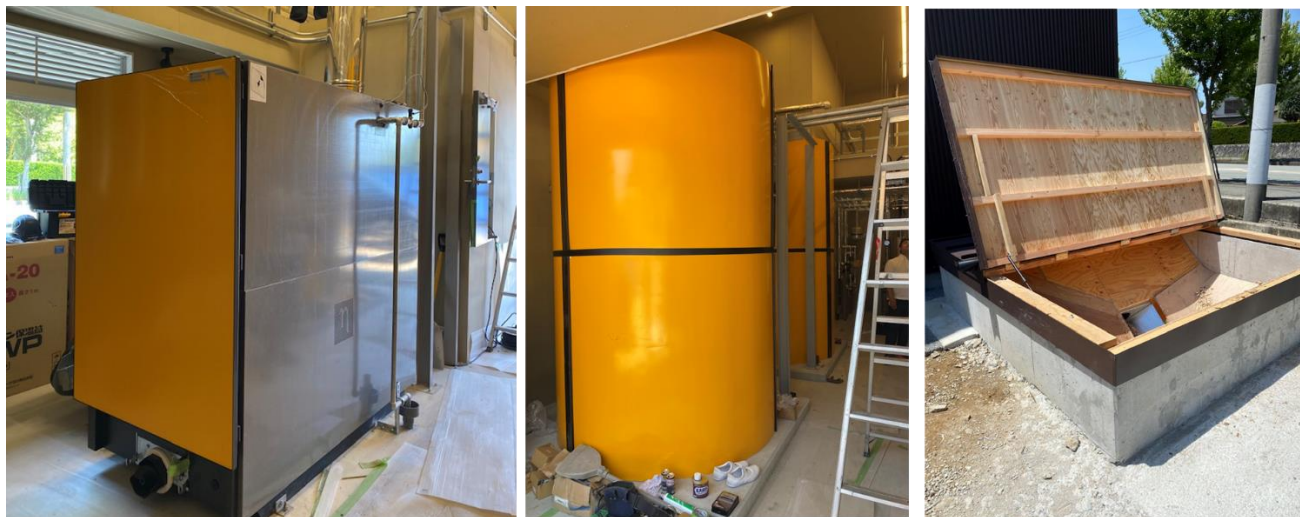
図 5 交流施設バイオマスボイラ
